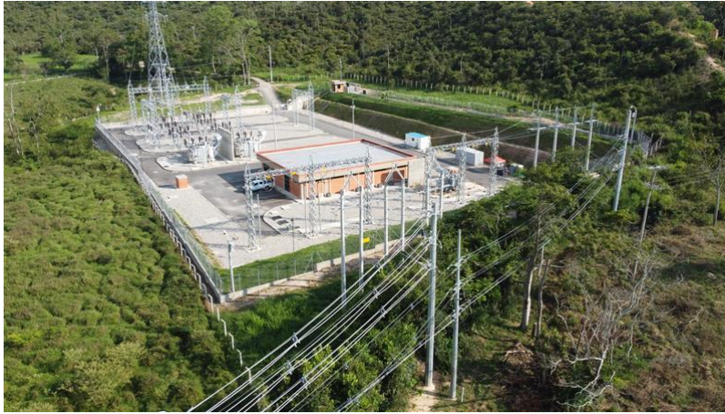
Subestación Rio Frio
