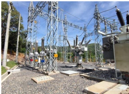
Subestación San Gil
