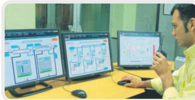
Monitoreo Unidades de Generación TERMOBARRANCA
