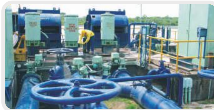
Unidad Bocatoma TERMOBARRANCA
